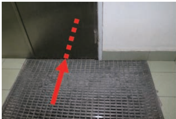
电缆在地板下穿过防护门处未封堵
