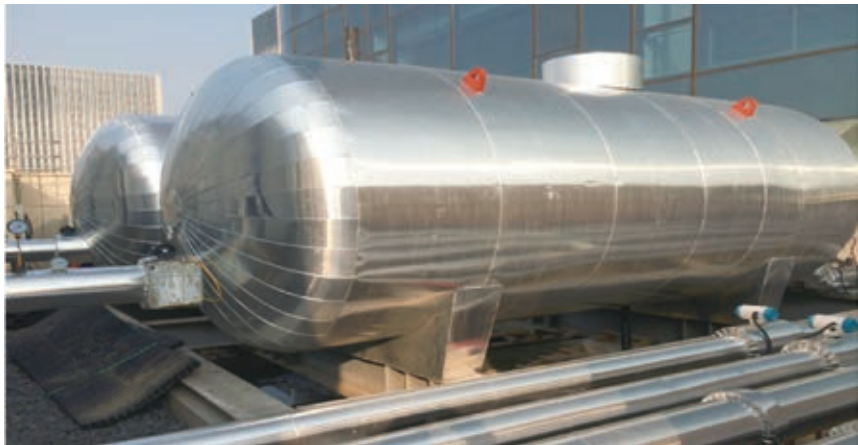
25 × 2 立方蓄冷水罐系统
